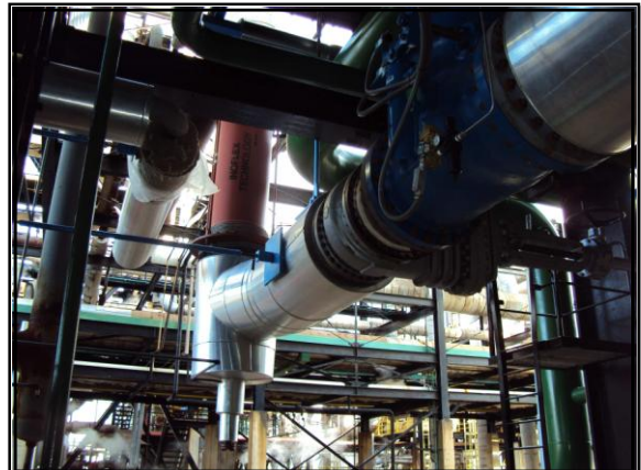
Tubazione vapore principale. Main steam pipe.
