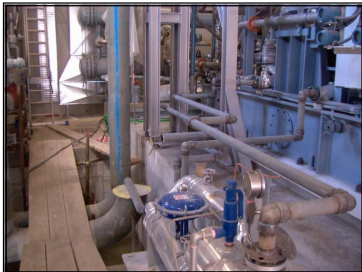
Tubazioni interconnessione bordo turbina.
