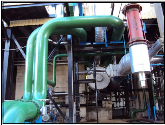
Tubazioni in-out acqua al condensatore. Water pipes inlet-outlet the condenser.
