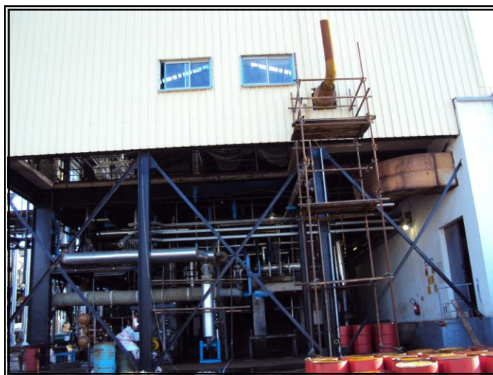
Vista esterna con linea a valvola sicurezza/sfiato. Safety valve view.
