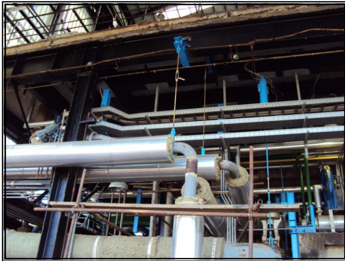
Piping e passerelle elettrostrumentali. Pipes and cable gangway.
